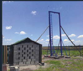
Water pump sta- tion - RDC
